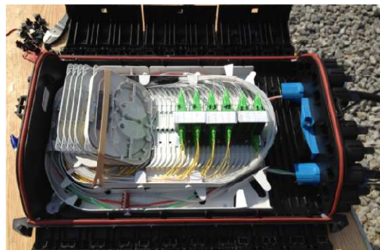
Рис.1 МС на базе муфты ВРЕО II с установленным сплиттером 1:32.
